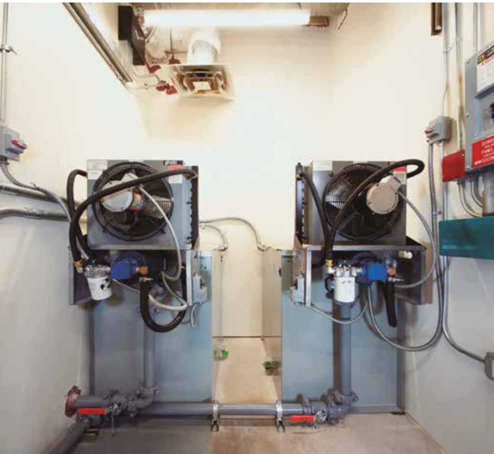
Unidad de potencia hidráulica sumergible de un sistema de ascensor modernizado con enfriadores de aceite instalados.
